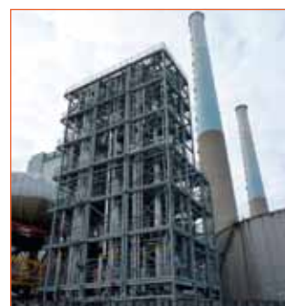
Pilote de la centrale thermique du Havre (EDF-Alstom) de 1,1 t/h
