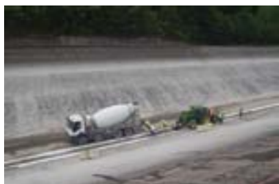
INSTALLATION OPTIQUE DU CANAL DE CURBANS
